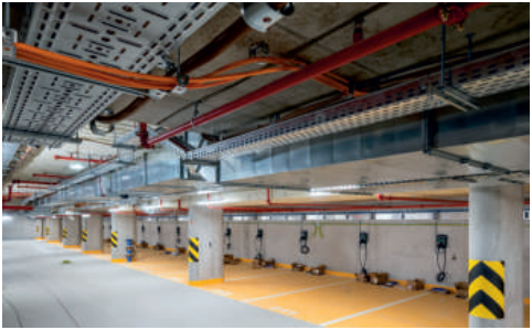
Technická zařízení jsou vedena pod stropem jednoho z parkovacích suterénů.
