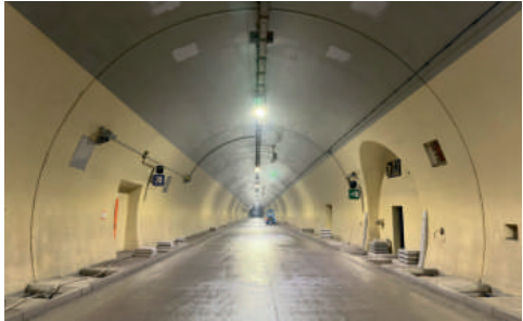
Průjezdové osvětlení tunelu tvoří LED jednotky v rozteči zhruba 22 metrů.
