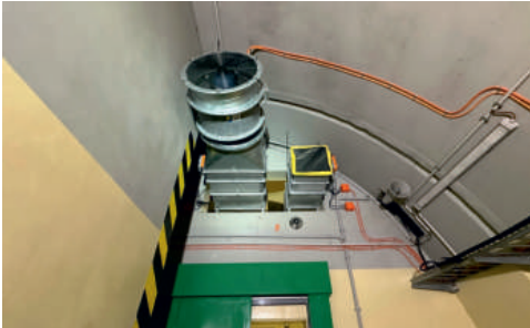
Vzduchotechnická část zahrnovala také větrání tunelových propojek.
