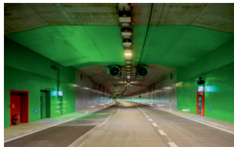
Technologické vybavení tubusů doplňuje výrazný nátěr bezpečnostních prvků.
