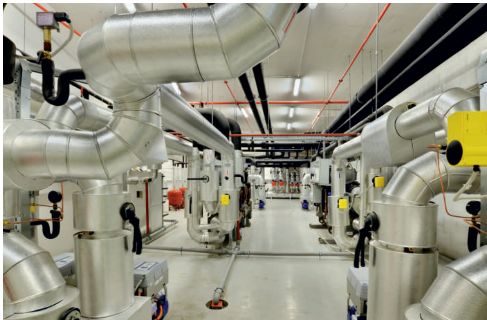
Divize 4 dodává kompletní technická zařízení budov. Největší dosud dokončenou zakázkou v této oblasti jsou instalace pro obchodně-administrativní centrum Florentinum v Praze.
