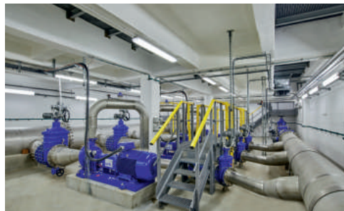
Novou vodní technologii dostala čerpací stanice v pražských Hrdlořezech.
