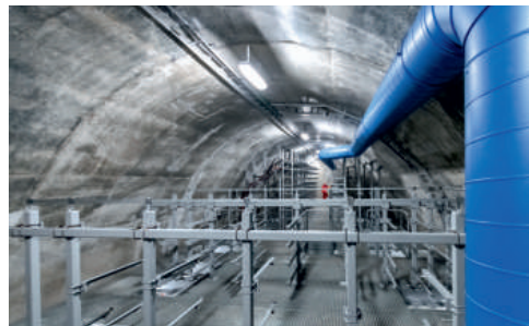
Nejnovější součást pražské kolektorové sítě tvoří kolektor Hlávkův most.
