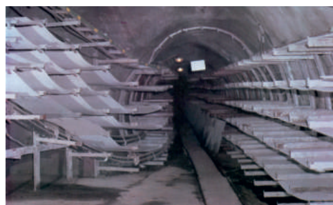
Předchůdce kolektorových sítí v hlavním městě představují kabelové tunely.
