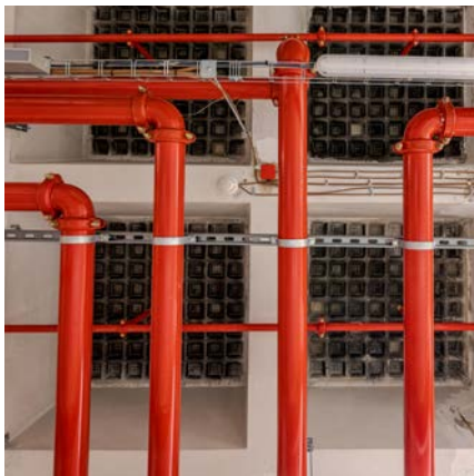
TZB při rekonstrukci Bubenská, Praha Service Systems for the reconstruction of Bubenská building, Prague
