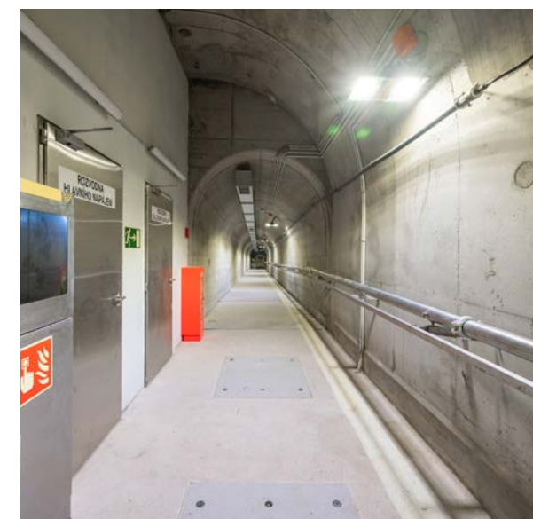
TZB při výstavbě VMD Žabovřeská, Brno Service Systems of the Žabovřeská tunnel, Brno
