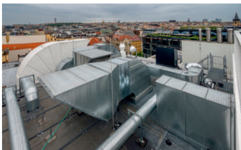
Část objemných vzduchotechnických zařízení je umístěna na střeše.
