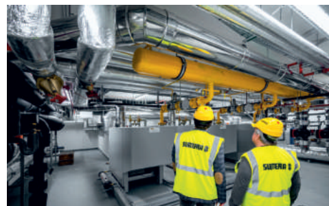
Kotelny a další technické místnosti obchodního domu jsou velice rozsáhlé.
