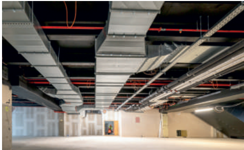
Rozsáhlé prodejní plochy vyžadují dostatečně dimenzovanou vzduchotechniku.
