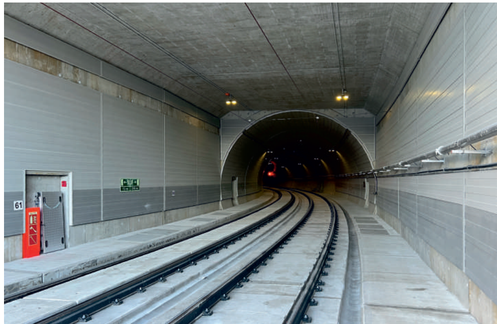
Tunel včetně technologického vybavení a bezpečnostních prvků je téměř připraven na zahájení provozu. V portálových úsecích má sekundární ostění akustický obklad.
